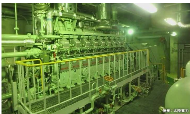
図 6 停止した非常用ディーゼル発電機
